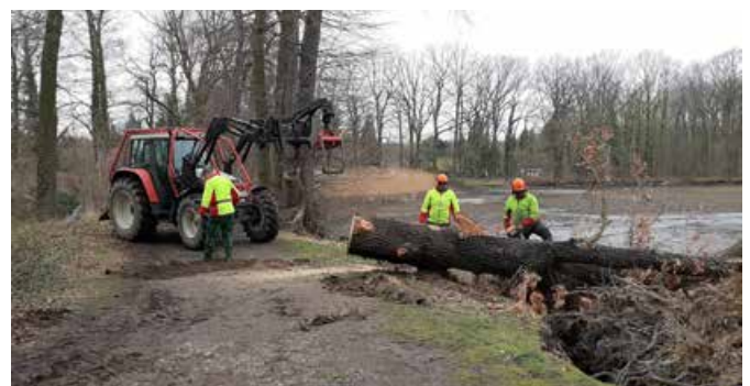
Kleiner Rummel, Dammschaden durch umgestürzten Baum
