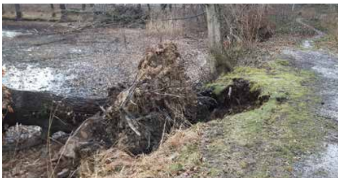
Kleiner Rummel, Dammschaden durch umgestürzten Baum
